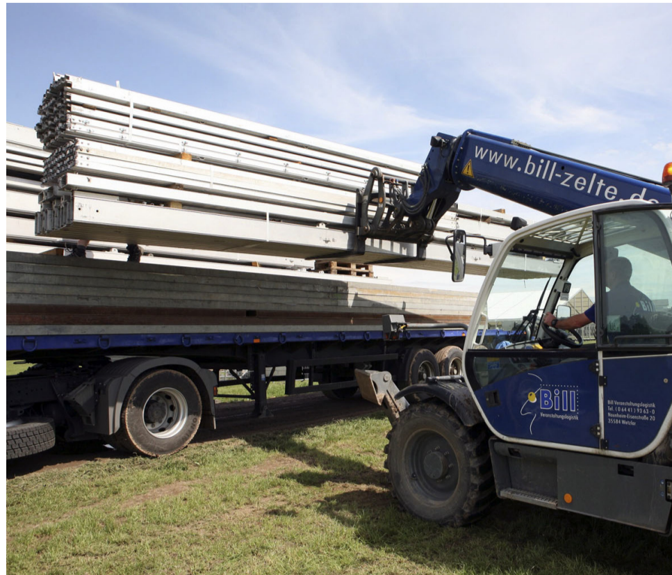
Mit schwerem Gerät auf den Wiesen unterwegs: Richtmeister Thorsten Kugler und seine Kollegen befördern die Alu-Konstruktionen an ihren Platz.
